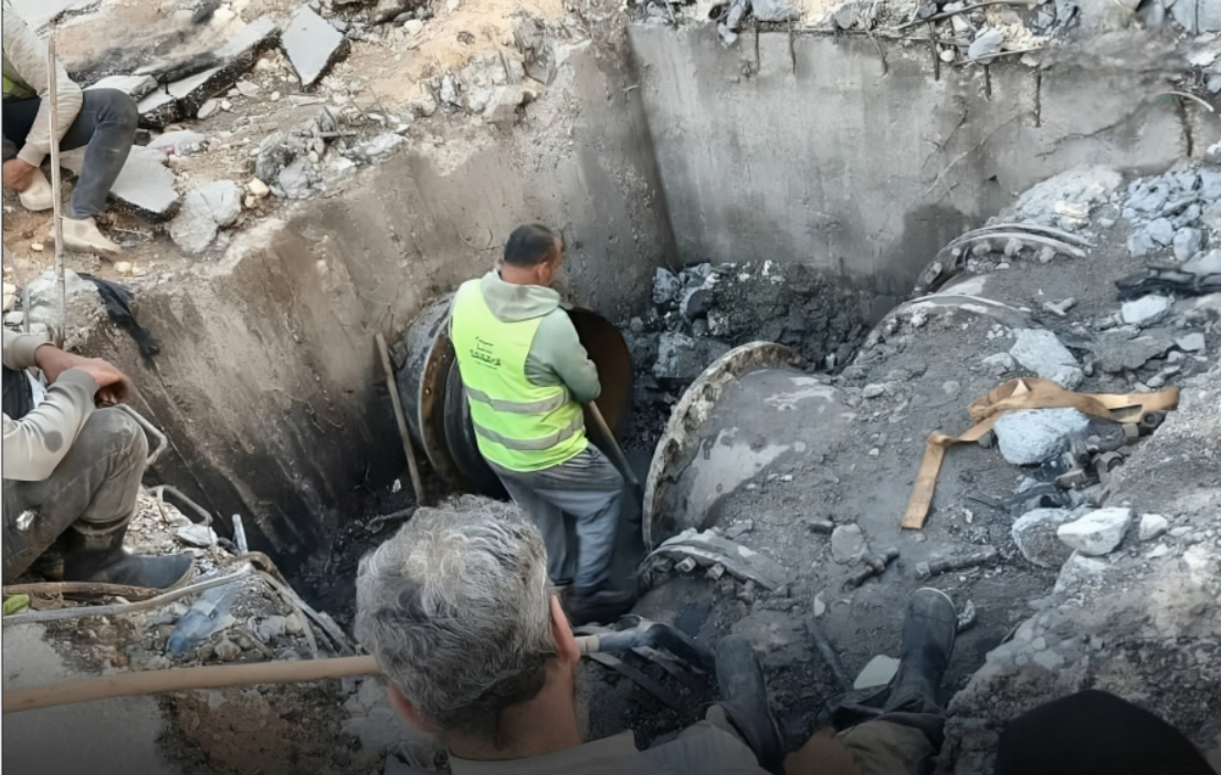
استكمال أنابيب وشبكة الصرف في حي سيف الجوزة بقرية حلب - 29 نيسان 2026 (الشبكة الخاصة لعرب الشرب في حي/ سيف الجوزة)
