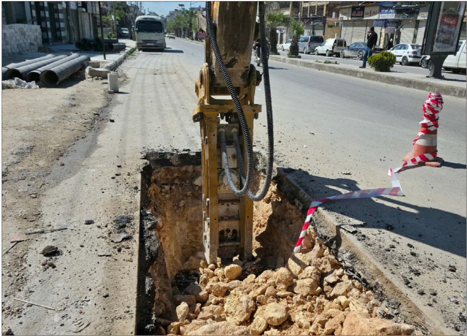
استبدال الخطوط القديمة لشبكة المياه في حي سيف الدولة بمدينة حلب - 23 نيسان 2026 الشركة العامة للمياه والشرب والصرف الصحي في حلب
