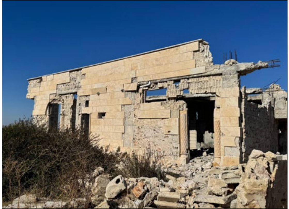
منزل بلا أبواب ونوافذ ومدمر جزئياً من قبل قوات النظام السوري في بلدة عمرشمشة بريف إدلب الجنوبي - 7 كانون الأول 2024 (نصب بلدي / سماح علوش)
