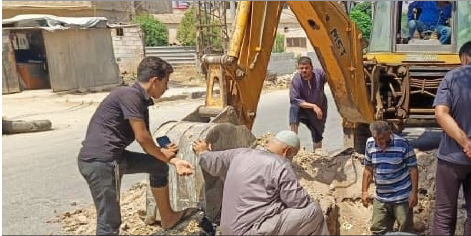
إزالة التصدعات على خط مياه الشرب في محبة درعا البلد - 15 من تموز 2024 لفريق درعا الإعلامي / فيس بوك
