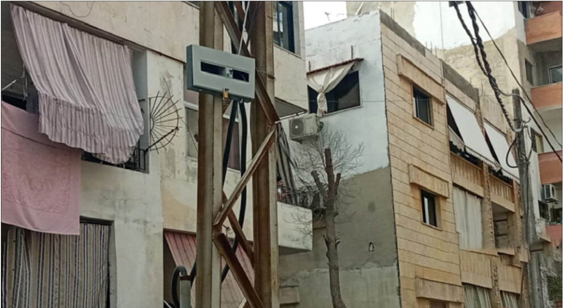
عَداد لإحصاء مولدات أشراك الكهرباء (أمبيرات) في حي القلعة (بنايات الساجع من نيسان) في مدينة اللاذقية - آب 2022 (عنب بلدي)
