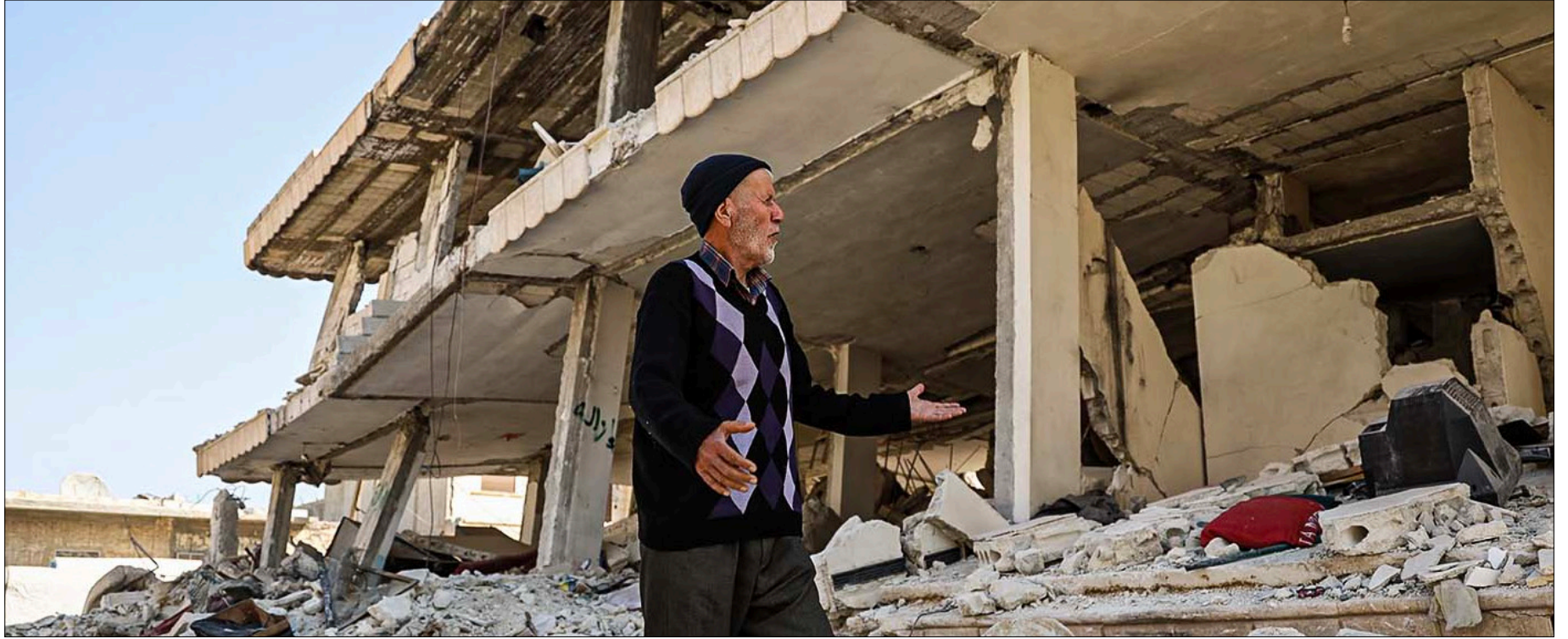
رجل مسن يعاين أضرار الأبنية في حي يسكنه بمدينة جنديرس بريف حلب بعد الزلزال الذي ضرب شمالي غربي سوريا - 24 شباط 2023 (عنب بلدي / أمير خربطلي)
