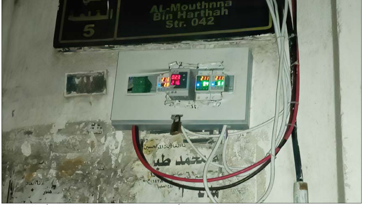
عداد لإحدى مولدات اشتراك الكهرباء (أمبيرات) في حي القلعة (بنايات السابع من نيسان) في مدينة اللاذقية - أيلول 2022 (عنب بلدي)
