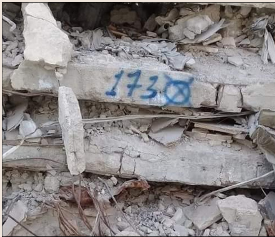
مبنى في مخيم "اليرموك" وضع عليه إشارة دائرة وبداخلها إشارة "X" بدلالة على عدم صلاحه للسكن (شتات برس)
