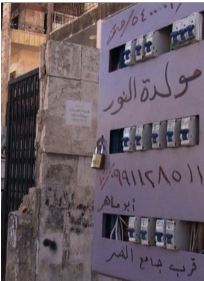
مولدة كهرباء في حلب - 2018 (أثر بريس)
