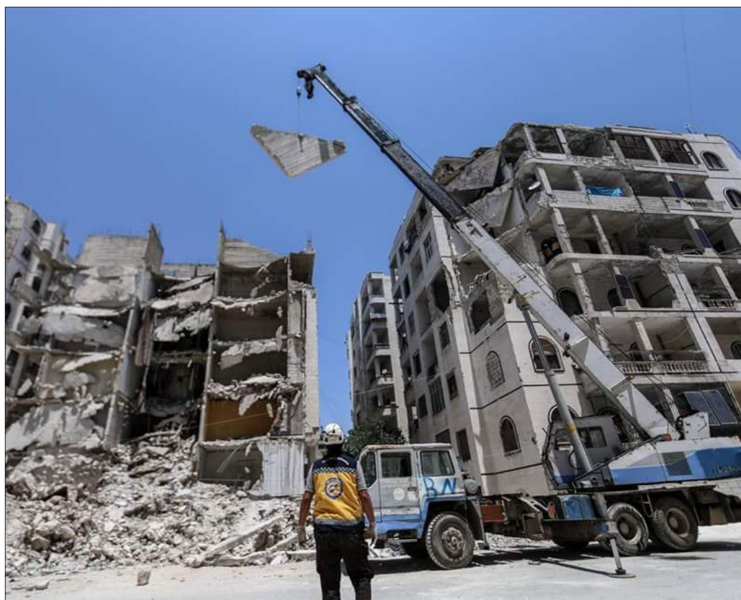
فرق الدفاع المدني في إدلب تزيل بقايا أسقف أحد الأبنية المدمرة جزئياً خشية سقوطه - 12 تموز 2020 (صفحة هاني إدلب في فيس بوك)
