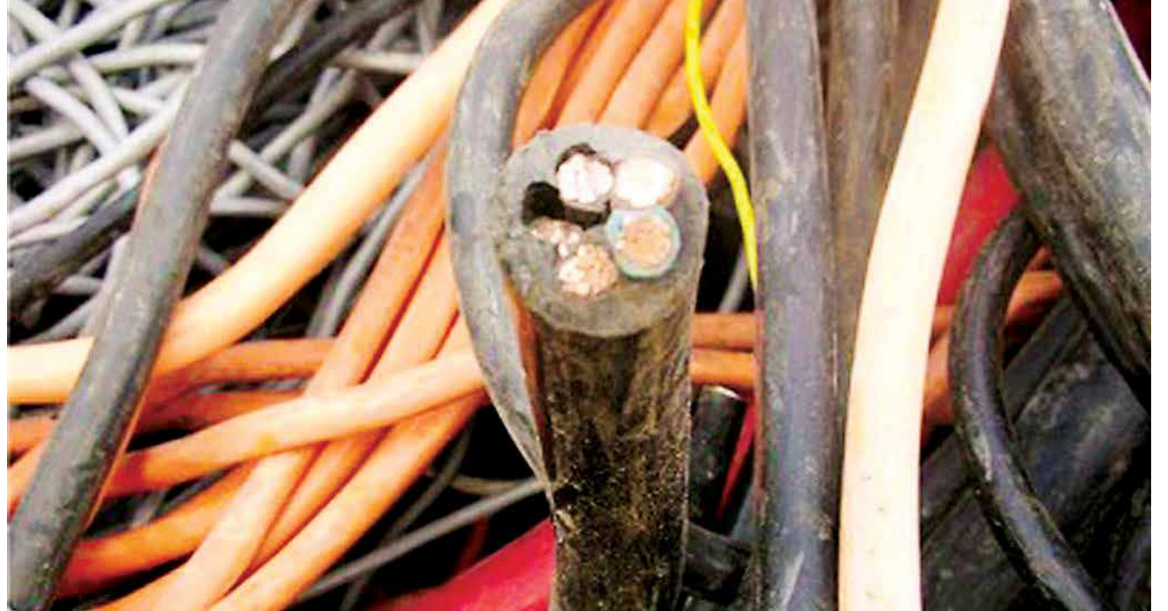
لم توفر عمليات السرقة كابلات الكهرباء والهاتف وكل ما يمكن بيعه (أرشيف)
