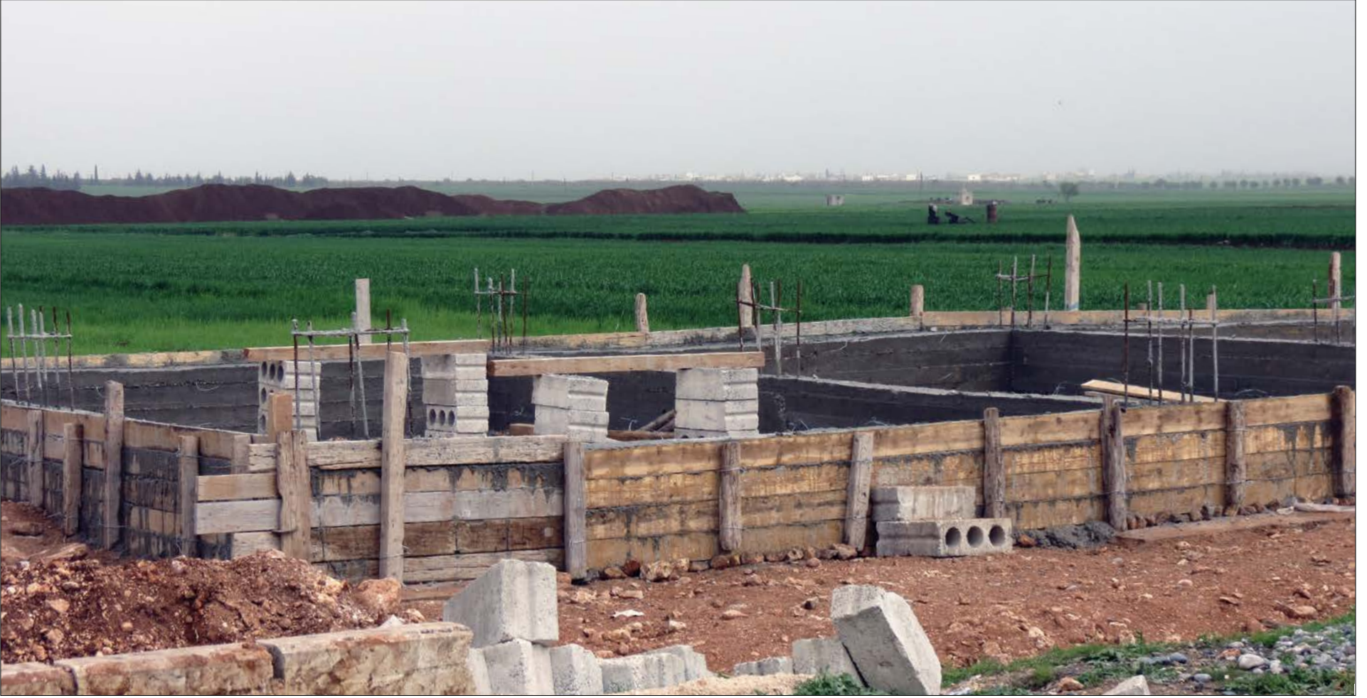
أساسات لأحد البيوت المبنية حديثاً في بلدة احتيملات شمال حلب 20 نيسان 2017 - (عنب بلدي)
