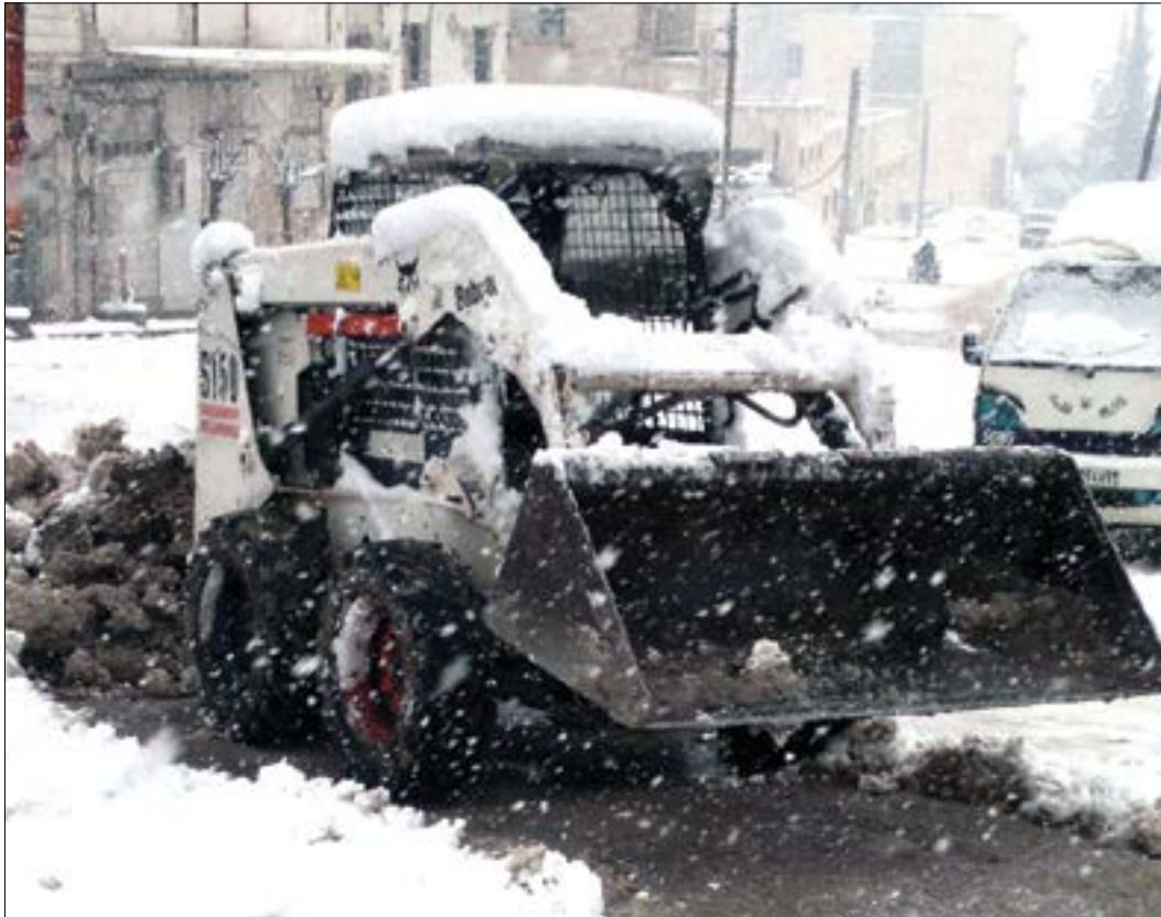
من أعمال بلدية مدينة إدلب في فتح الطرقات إثر تراكم الثلوج - 23 كانون الأول 2016 (عنب بلدي)
