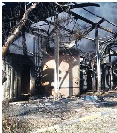
الحرائق في محطة زيزون الحرارية - السبت 1 آب 2015
