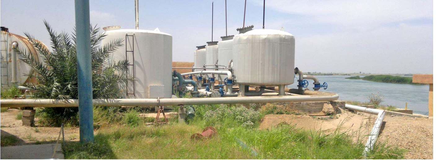
محطة تصفية المياه في بلدة بقرص
